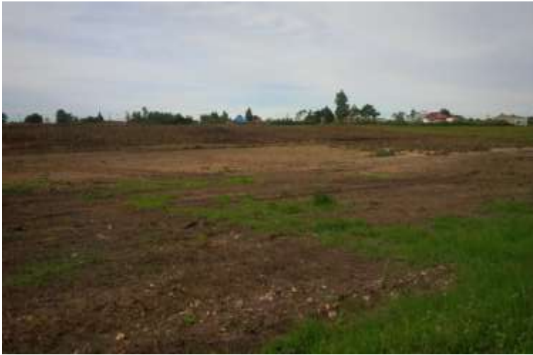
Gbr. Lahan yang telah dilaksanakan penataan ulang layout Instalasi
